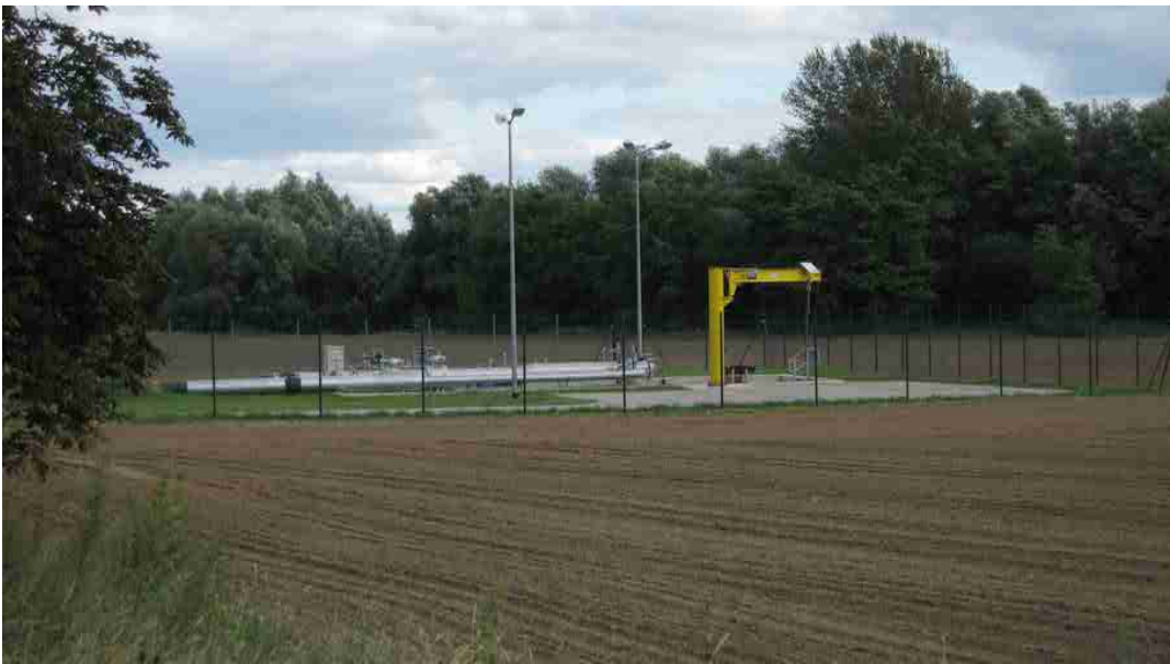
Die Schieberstation DS III der Rohölpipeline "Freundschaft 2" regelt den Ölzfluss zum PCK Schwedt.
